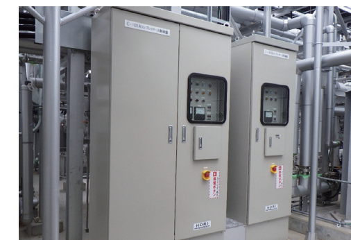
制御盤製作も可能
